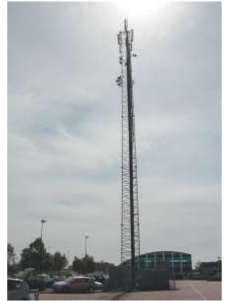
Figura 5: Torre de Telecomunicaciones
